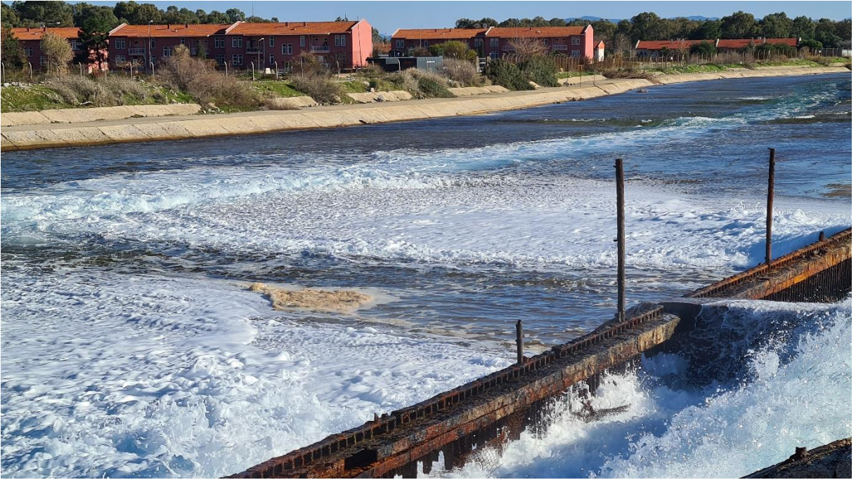
Foto 8-1. Kemerköy Termik Santrali'nden Hanay Deresi'ne yapılan soğutma suyu deşarjından birer görünüm.
