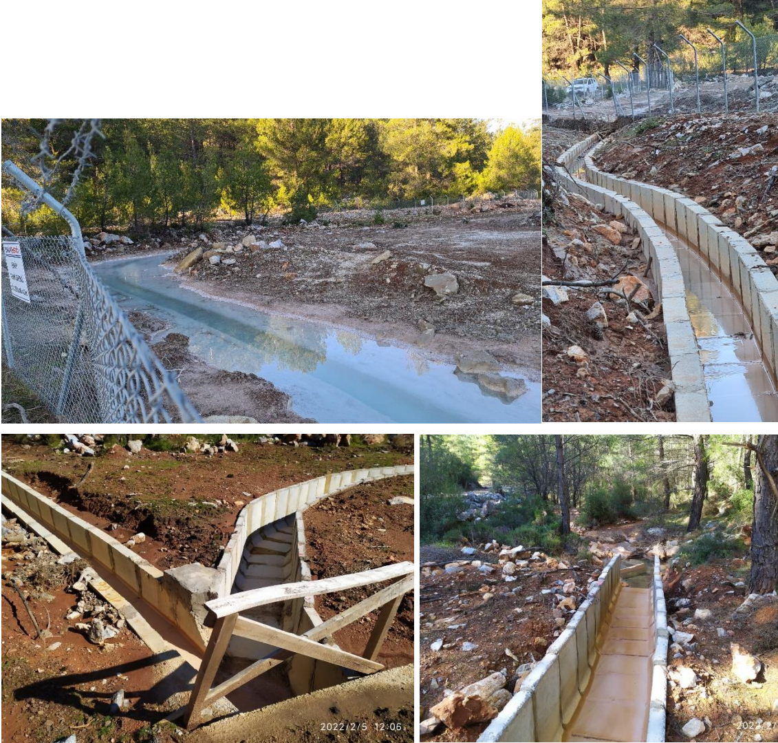
Foto 8-5. Yeniköy Termik Santrali kuşaklama kanalından saha dışındaki orman içersine yapılan deşarjdan bir görünüm.
